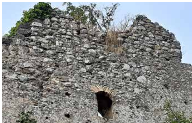
Fig. 62 – Castel Vetrano, Fuorni. Particolare delle mura di cinta, lato Est. Da notare la finestra con arco a sesto acuto e ghiera di laterizi (foto Alfredo Nicastrì)
