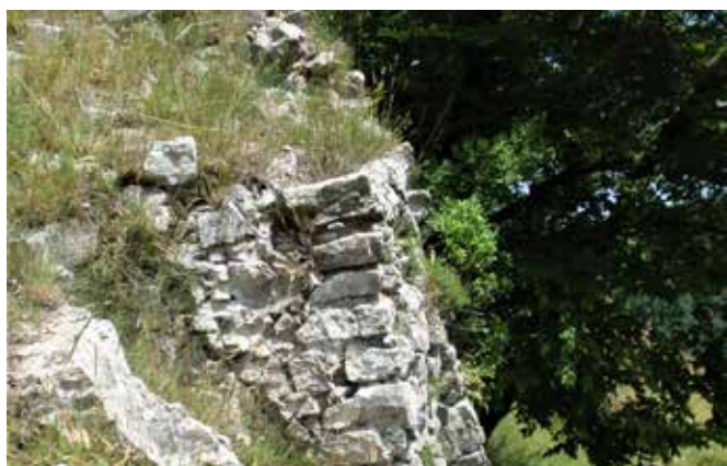
Fig. 85 – Monte Bastiglia. Versante Sud, muro di contenimento del terrazzamento. Particolare della tecnica costruttiva (foto Alfredo Nicastri)
