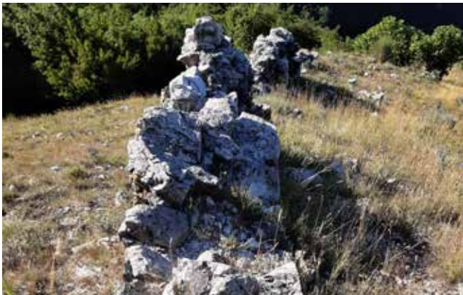
Fig. 79 – Monte Bastiglia. Mura orientali, particolare della sezione. Come si può notare i due pannelli esterni sono scarsamente connessi al nucleo a causa dell'assenza di diatoni (foto Alfredo Nicastrì)
