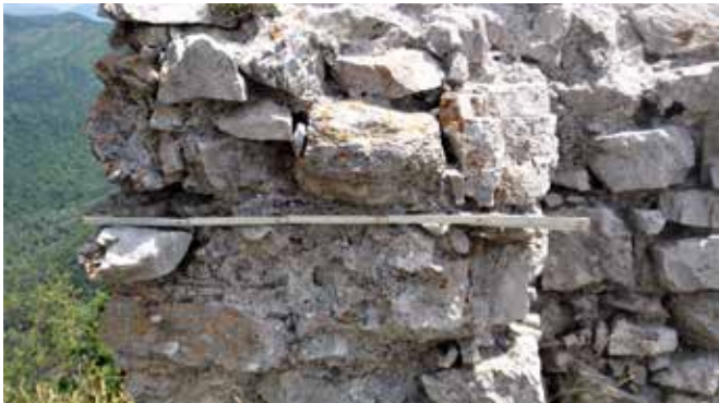
Fig. 78 - Monte Bastiglia. Particolare delle mura della cappella (larghezza cm 90 ca.). Si può notare la scarsa connessione tra le pietre, compensata dall'abbondante utilizzo di malta, ed anche la ridotta dimensione del diatono in basso a sinistra, che non supera la metà dello spessore del muro (foto Alfredo Nicastrì)
