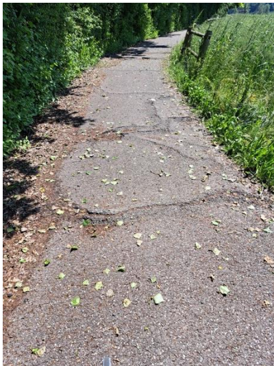
Figura 6.3 Rialzo manto causa radici. Comune di Cervarese S. Croce (PD)
